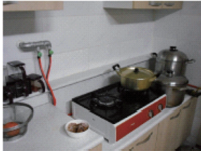
▲ 가스누설경보기가 미설치된 경우
