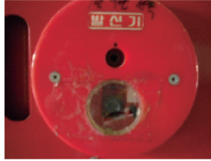
▲ 발신기의 파손을 방지한 경우
