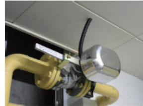
▲ 가스누설경보기의 차단밸브가 설치된 사례
