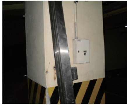
▲ 방화셔터 레일이 파손된 상태로 방치한 경우
