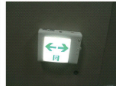
▲ 통로유도등이 올바르게 설치된 경우
