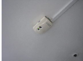
▲ 가스누설경보기의 탐지부가 설치된 사례
