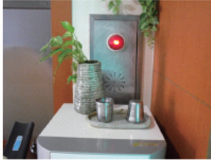
▲ 적재물로 인하여 소방시설의 사용이 제한되는 경우
