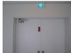
▲ 피난구 유도등이 올바르게 설치된 경우
