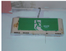
▲ 유도등이 부식되어 점등되지 않는 경우
